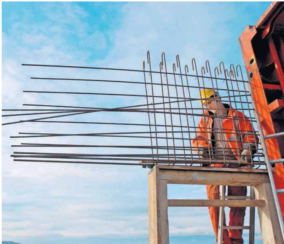
Dans la construction, nombreux sont les ouvriers qui peuvent bénéficier d'un financement pour une formation. Un avantage dans ce secteur qui compte beaucoup d'étrangers dépourvus de bagage suffisant. J.-P. GUINNARD
